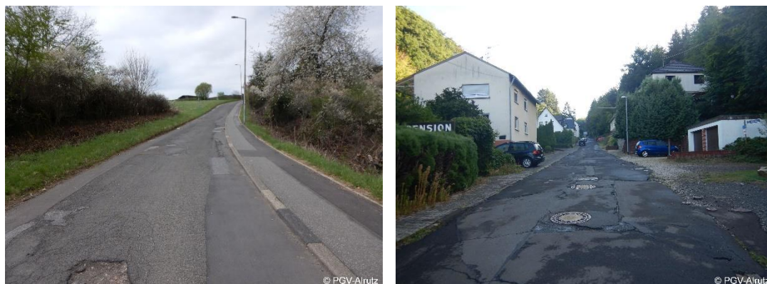
Abb. 2-4: Belagsschäden Heinzenwies (Zufahrt Gymnasium) (links) und Andreastraße (rechts)
